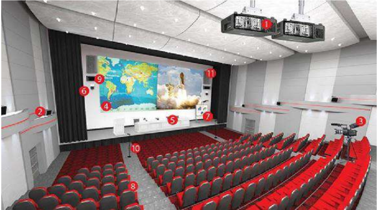
Рисунок 14.1 – Розташування основного обладнання конференц-залу: 1 – відіопроектори; 2 – акустична система навколишнього звуку; 3 – камери ПТС (багатокамерна (від 2 до 8 камер) пересувна телевізійна станція); 4 – екран; 5 – робочі місця президії; 6 – поворотна відеокамера; 7 – інтерактивна дошка; 8 – пульт інтерактивного голосування; 9 – випромінювач бездротової системи синхрперекладів; 10 – мікрофони учасників конференції; 11 – фронтальні акустичні системи
