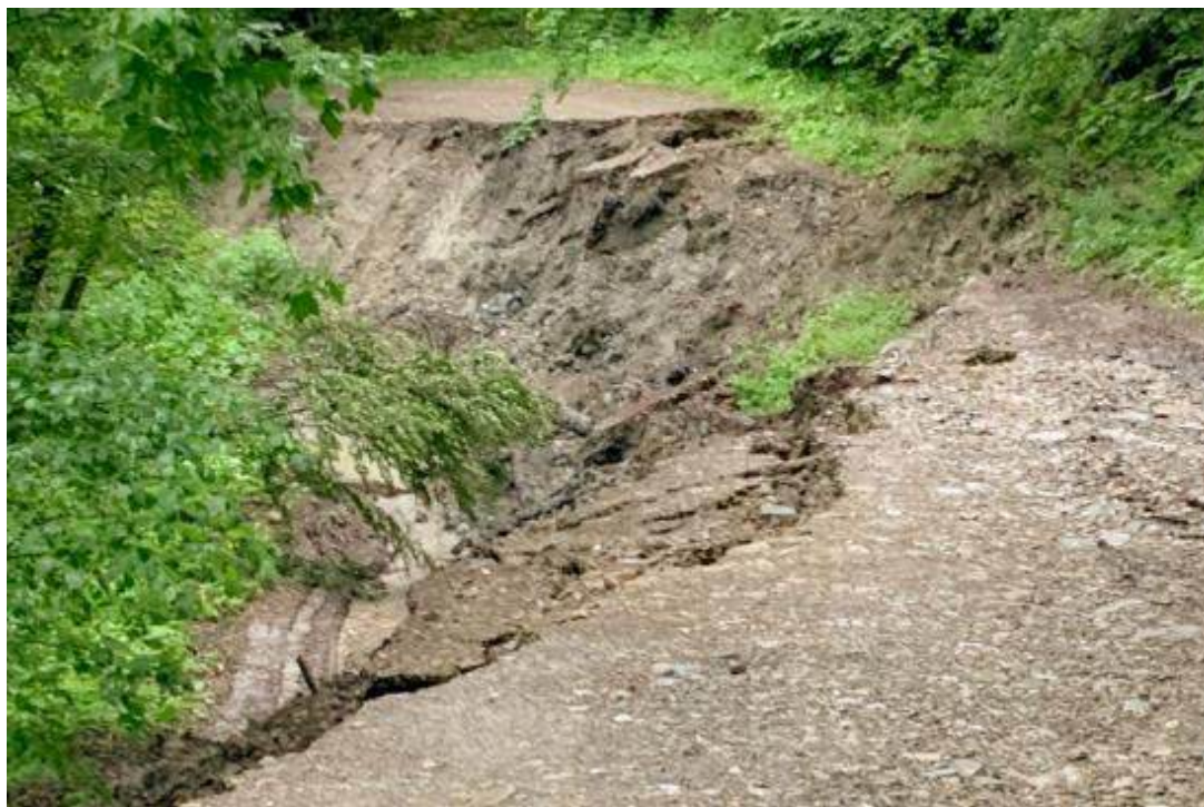
Рисунок 7.4 – Зсув ґрунту на автодорозі Східниця – Орів.
