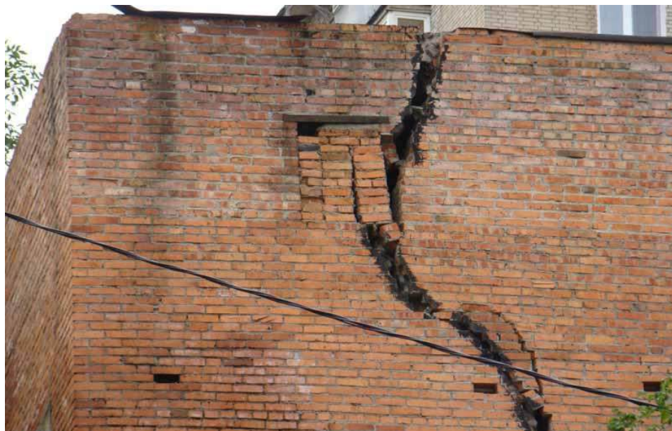
Рисунок 4.7 – Середнє руйнування будівлі
