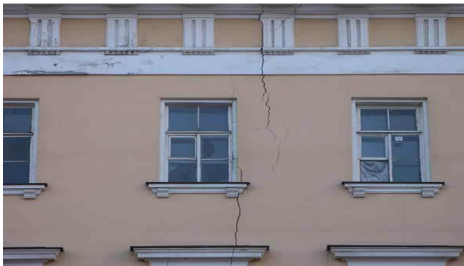
Рисунок 4.6 – Слабке руйнування будівлі
